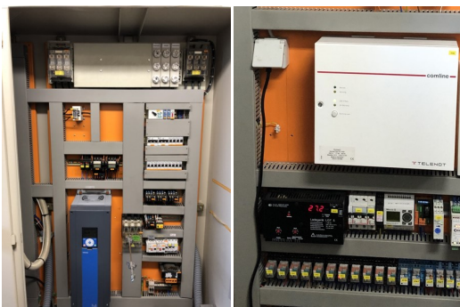
Schaltanlage Pumpstation Waldhausen
