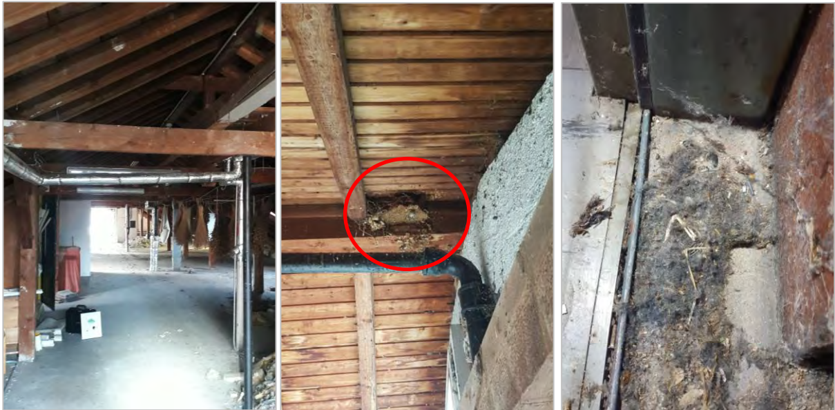
Abbildung 4: In dem überwiegend relativ hellen Dachgeschoss konnten alte Wespennester sowie Überreste mehrerer Vögel (vermutlich dem Haussperling) vorgefunden werden, welche sich in das Dachgeschoss verirrt hatten. (Fotos: Manuel Schulz, 17.03.2023)
