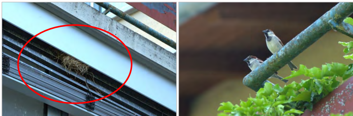
Abbildung 15: Der Haussperling brütete am Haus 8 vor allem in den Rollladenkästen mit mindestens 10 Brutpaaren. (Fotos: Manuel Schulz, 05.06.2023)
