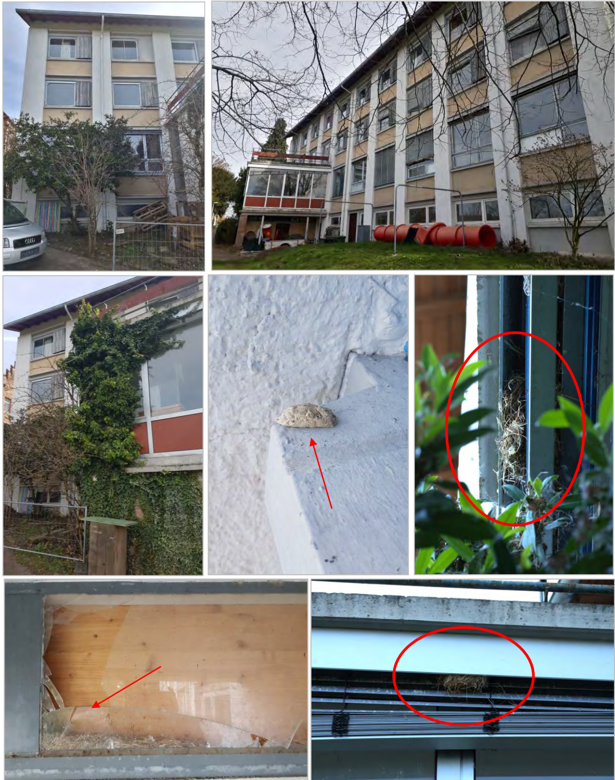
Abbildung 6: Die Westseite des Wohnheimgebäudes Haus 8 weist zahlreiche potentielle Quartier- sowie Nistmöglichkeiten für Fledermäuse und Vögel hinter den Fensterläden sowie in und hinter den Rollladenkästen auf, die gerne von Haussperlingen genutzt werden. Hinter einem beschädigten Glasfenster hat ein Hausrotschwanz sein Nest gebaut (Bild unten links). Ruhe und Versteckmöglichkeiten bieten Gehölze und Efeu. Auf den obersten Fensterbänken finden sich Gewölle, welche dem Turmfalken zuzuordnen sind, der diese Bereiche als Schlafplatz nutzt (Bild Mitte). (Fotos: Manuel Schulz, 17.03.2023 (oben, Mitte), 25.05.2023 (unten))
