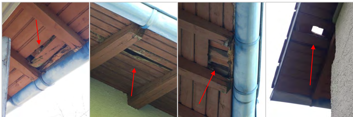
Abbildung 9: Unterhalb der Dachtraufe finden sich auf der westlichen Seite des Wohnheimgebäudes Haus 8 mehrere beschädigte Stellen, welche potenzielle Fledermausquartiere darstellen sowie von dem Haussperling als Nistplatz genutzt werden. (Fotos: Manuel Schulz, 17.03.2023)
