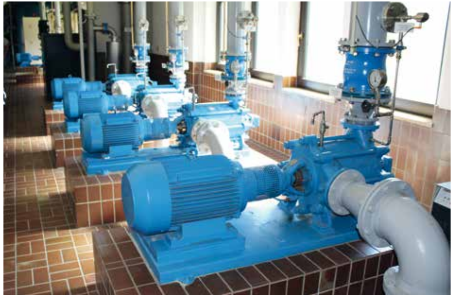
Hauptförderpumpen im Wasserwerk
