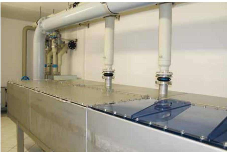
Der Flachbettbelüfter dient der Entsäuerung des geförderten Trinkwassers
