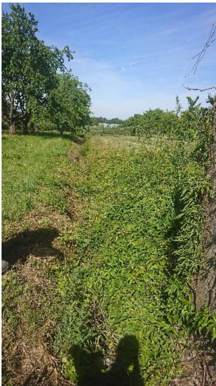
Abbildung 5 Überwucherter Wassergraben an der nördlichen Grundstücksgrenze.
